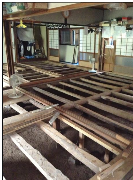
8月28日 江津市桜江町 床下浸水（汚泥搬出後の様子）
